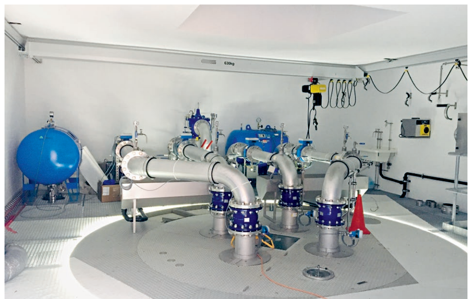
Innenansicht: Grundwasserpumpwerk Rheinfall
